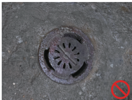
1-锈蚀的防爆地漏
