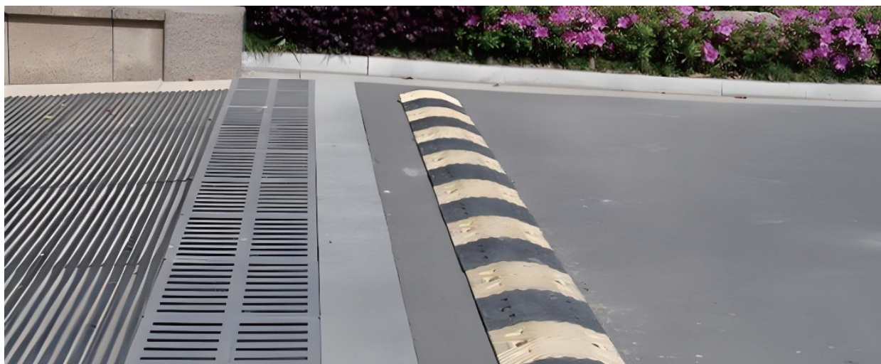
人防地下室车库入口处雨水截水沟
