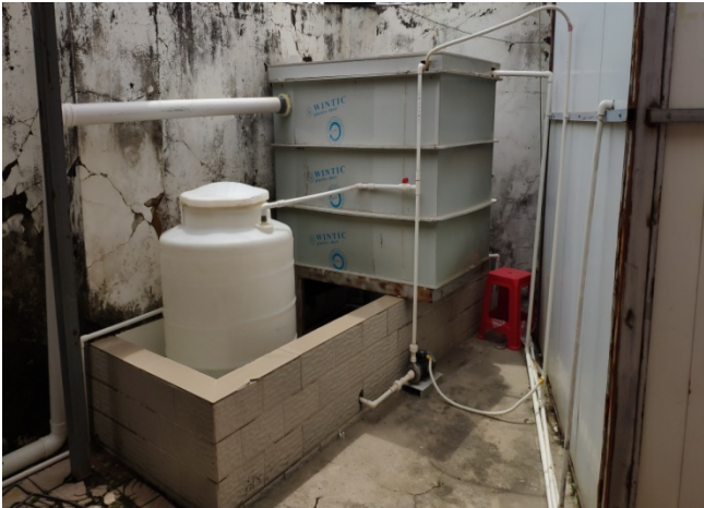
（不达标的污水处理设施）
